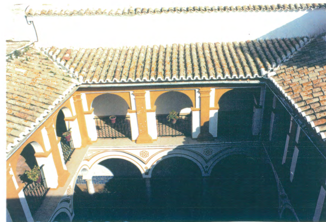
22. Vista desde la azotea del claustro superior. Está formado por pilastras toscanas adosadas al muro sobre el que se apoyan arcos rehundidos de medio punto, baranda de hierro forjado y cubierta de teja.
