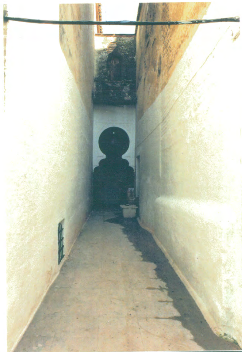
31. Pasaje existente en la zona del compás, por la que se tiene acceso a la Iglesia de Sta. María de la Mota, en su parte baja y superior.
