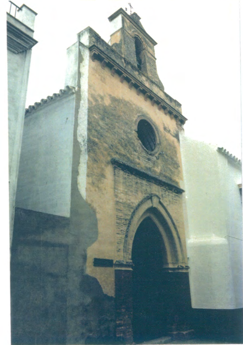
2. Fachada a c/ San Francisco en la que se observa el pasillo lateral que conserva el arquillo de arriostramiento.
