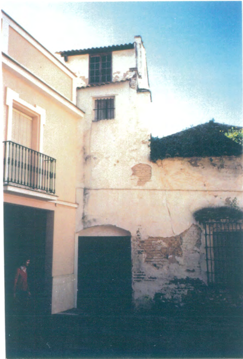
4. Detalle de fachada lateral a la barreduela de C/ Cilla, la puerta da acceso a una nave lateral de construcción posterior al resto del edificio.
