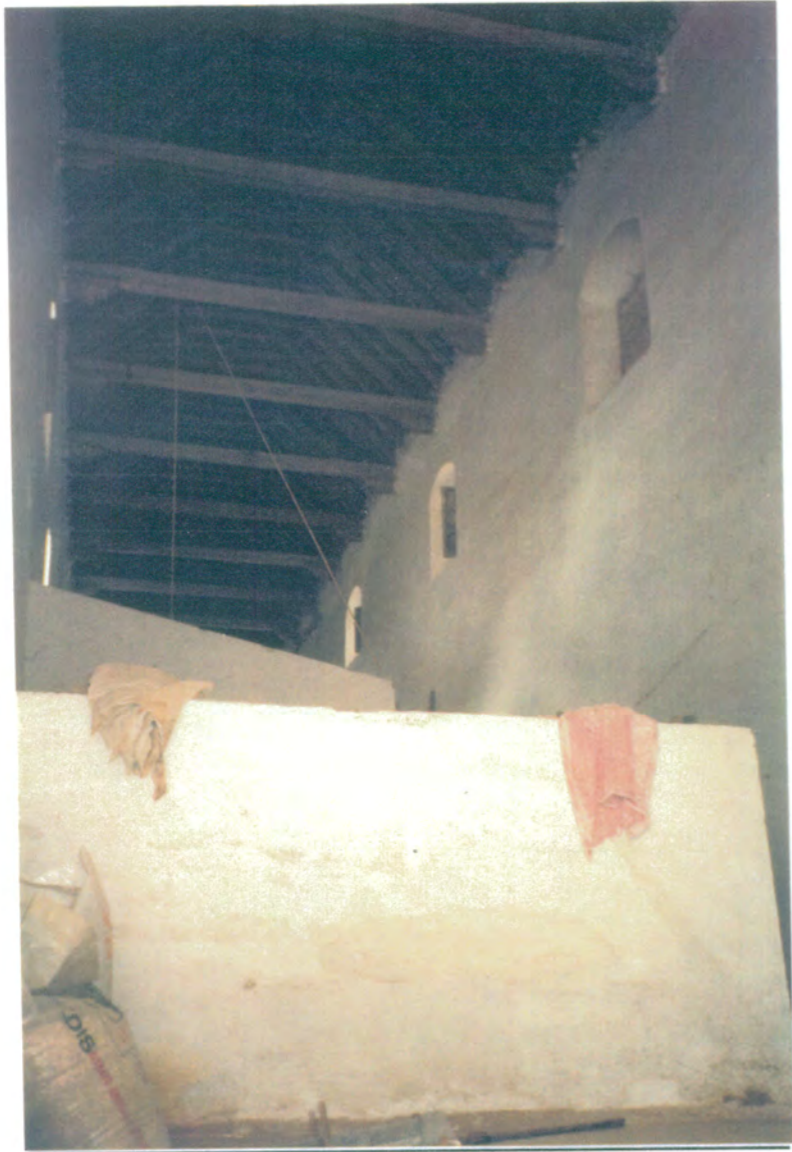
29. Interior de nave oeste, de dos plantas de altura, cubierta a dos aguas y artesonado de par y nudillo. (Vista en sentido contrario).
