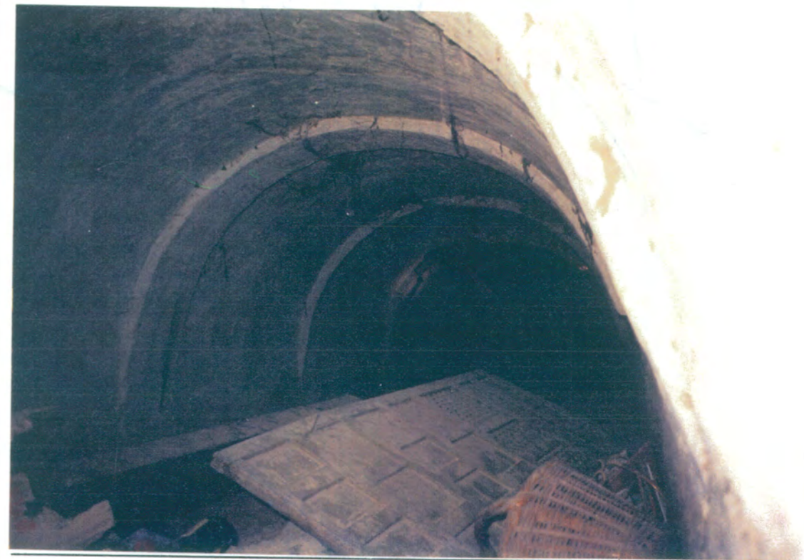
35. Semisótano formado por bóveda de cañón, que sirve para aislar el grano de la humedad.
