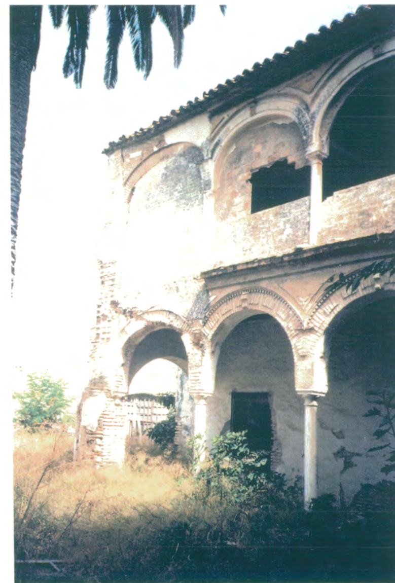
6. Vista de las galerías del ala norte desde el jardín principal, en esta fotografía se observa en el eje de la primera columna el arranque de arcos en planta baja y alta, ésto hace creer que las galerías continuaban hasta cerrar el patio.
