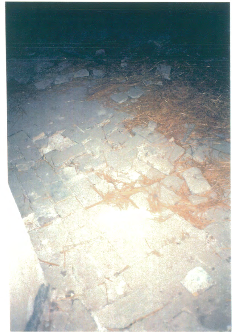
15. Pavimento del edificio se encuentra todo en muy mal estado.
