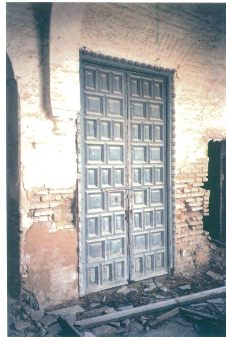
13. Detalle de puerta situada en la galería del ala este, al lado de la escalera.
