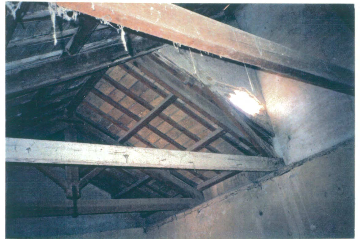
33. Detalle de cercha de madera, tirantes de hierro y ladrillo por tabla del ala sur, vista hacia su lado oeste.
