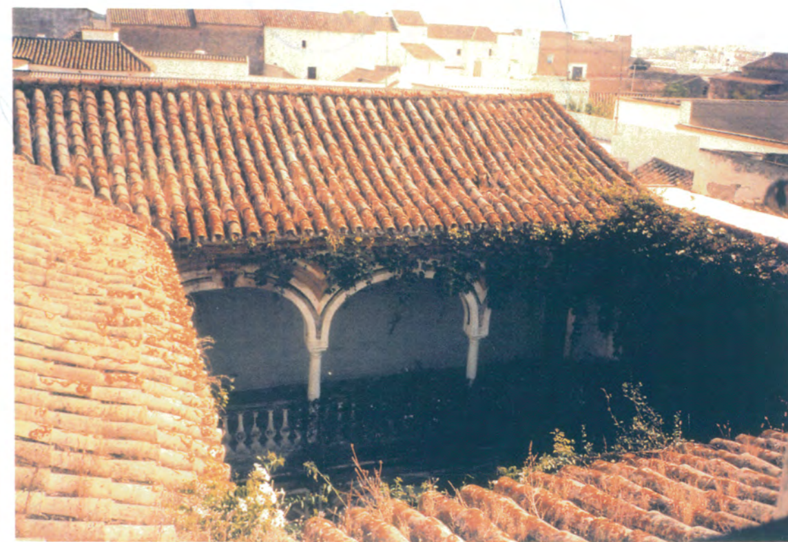
46. Desde la azotea del ala oeste, cubiertas de tejas de las galerías del patio principal, S. XVII.
