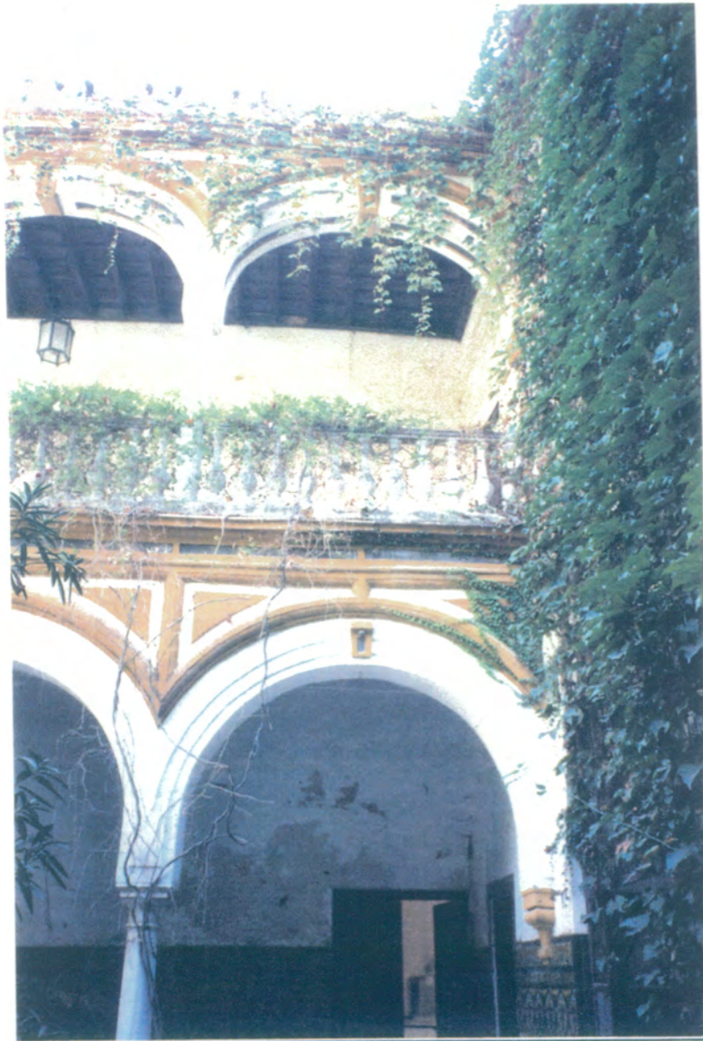
28. Vista de la planta baja y alta de la galería este del patio principal. La arquería en planta baja es de medio punto y rebajados en planta alta, todos sobre columnas toscanas, recercados y decorados con cartabones y claves resaltadas. En planta alta balaustrada muy interesante, artesbnado de tablazón, alfajias y vigería de madera.
