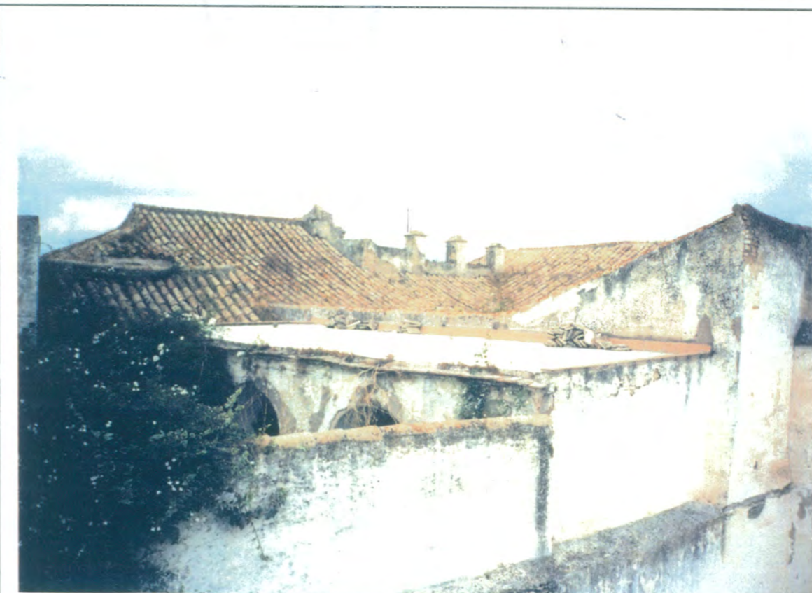
12. Vista desde la azotea de la primera crujía por c/Cristóbal de Morales hacia el ala norte. En primer plano los arcos de herradura del antepatio.
