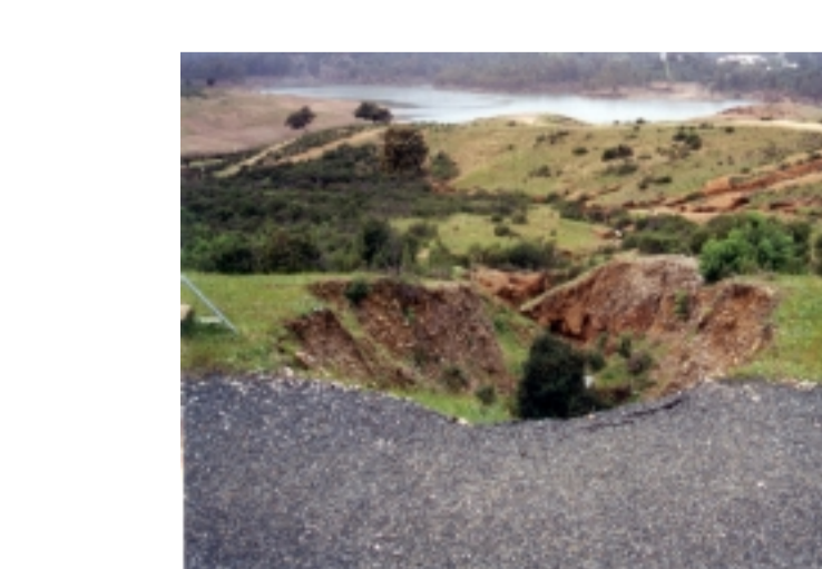
La salida de los pasos de agua bajo la vía son puntos de fuerte actividad erosiva que a veces afectan a la conservación de la misma.
