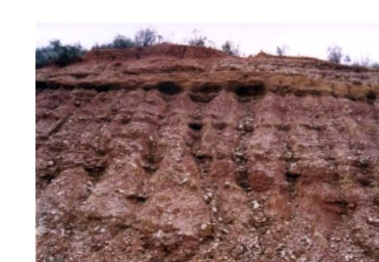
Inestabilidad en los taludes resultantes de la construcción de la carretera.
