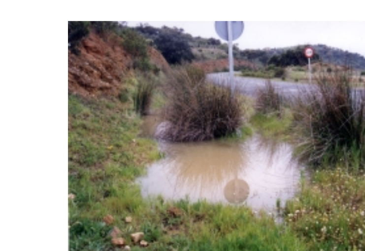
El nuevo trazado de la carretera alteró las condiciones de drenaje de la zona. Las cunetas de aquella canalizan y concentran las aguas de lluvia dando lugar a pequeños arroyos antes inexistentes.
